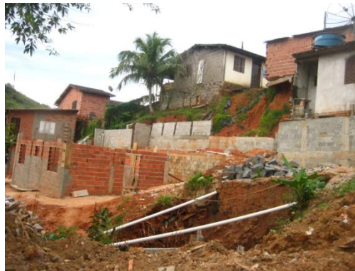
Área de risco à deslizamentos - Barra Velha/Ilhabela (Levantamento em campo, 22/11/2011)
